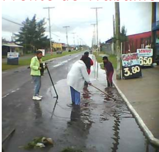
Trabalhadoras dentro das águas contaminadas sem proteção adequada
